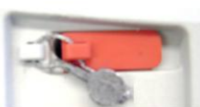
Блокировка включена и опломбирована проволочной пломбой
